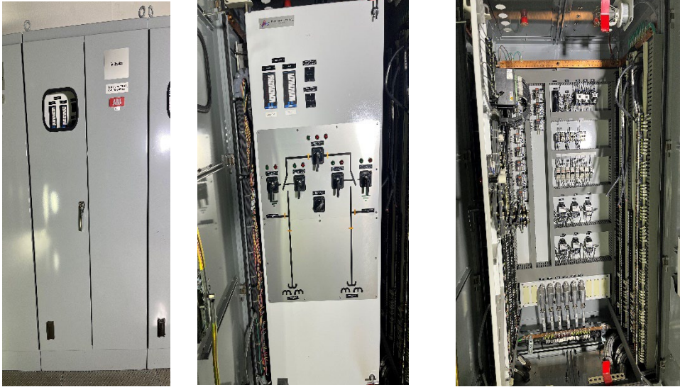
19) GIS 69 kV Tie Breaker B102 Panel
