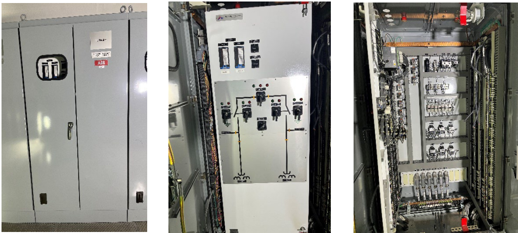
20) GIS 69kV Tie Breaker B103 Panel
