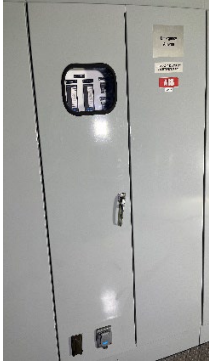
24) GIS Breaker B203
