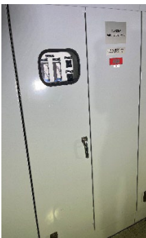
26) GIS Breaker B401
